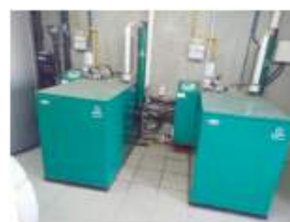
Calderes de cogeneració
