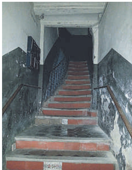
L'ESCALA DE LA FINCA DEL CARRER DEL ROSER, 19, ABANS DE COMENÇAR LES OBRES
