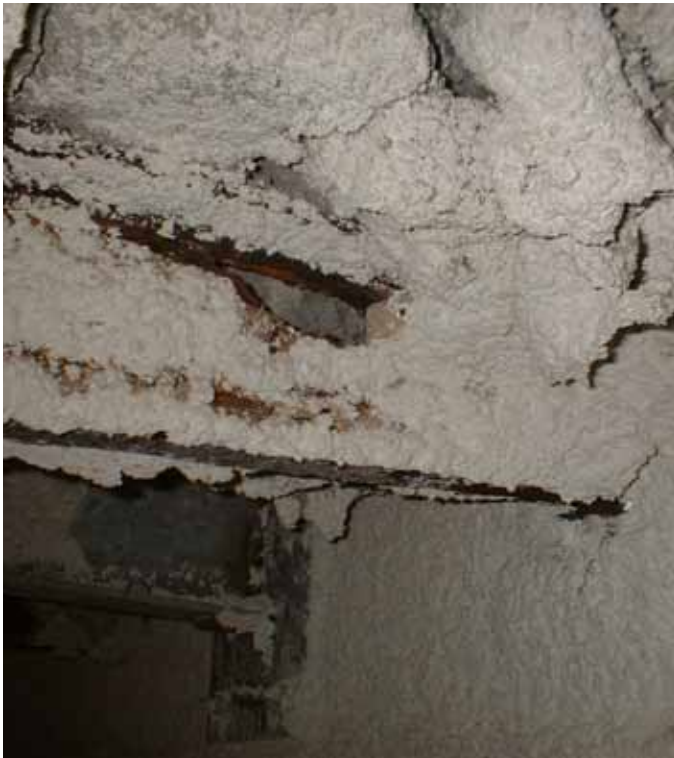
ESTAT DEL PERFIL "AMAGAT" PER LA PROTECCIÓ IGNÍFUGA FETA EN REHABILITACIONS ANTERIORS
