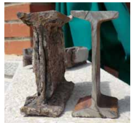
EXPANSIÓ DE LA SECCIÓ D'UN PERFIL A CAUSA DE L'OXIDACIÓ I EXFOLIACIÓ
