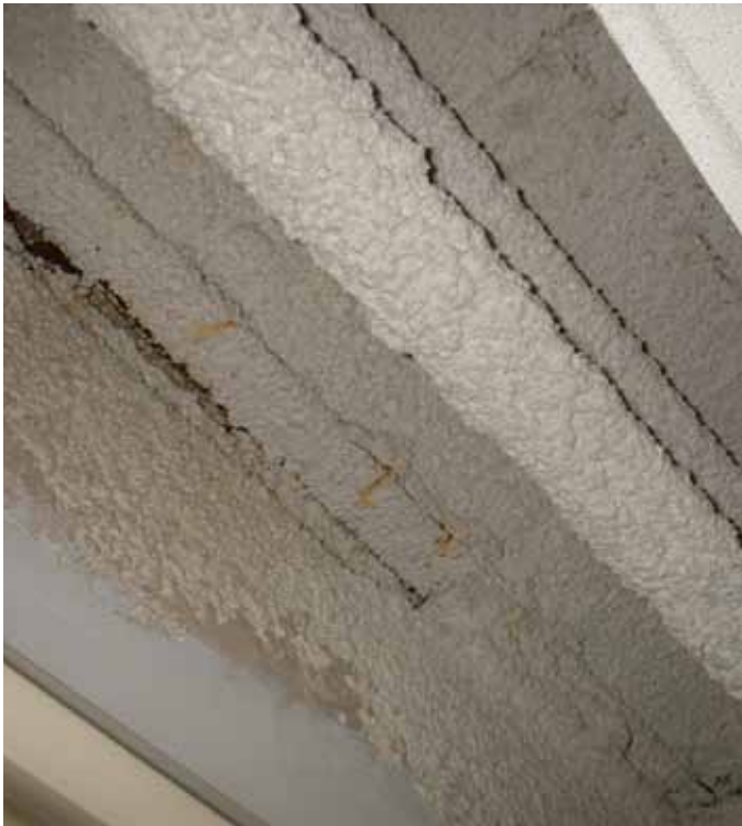
MANIFESTACIÓ DE L'OXIDACIÓ A TRAVÉS DE LA PROTECCIÓ IGNÍFUGA
