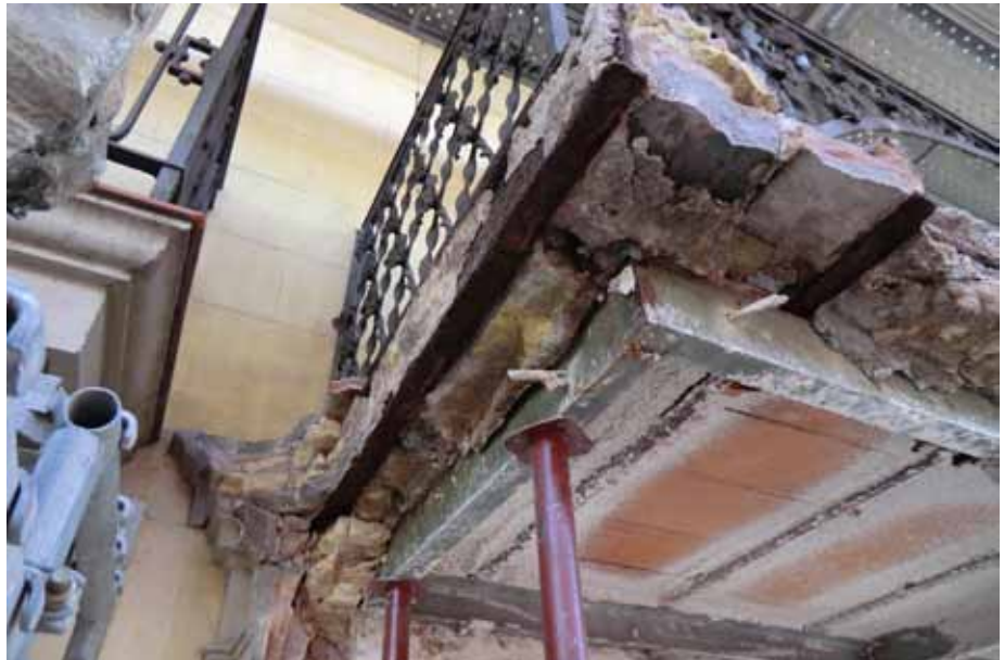
ESTINTOLAMENT FET EN REHABILITACIÓ ANTERIOR SENSE ELIMINAR LA CAUSA DE LES PATOLOGIES
