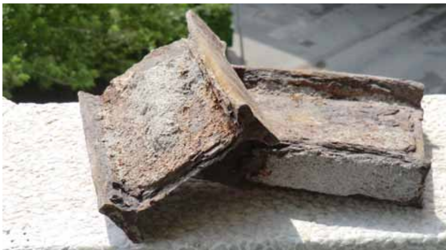
CAPS DE PERFILS OXIDATS I EXFOLIATS EN ZONA DE RECOLZAMENT
