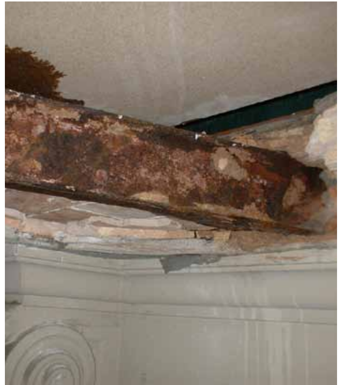
PERFIL DEL FORJAT DE LA TRIBUNA COMPLETAMENT OXIDAT I EXFOLIAT
