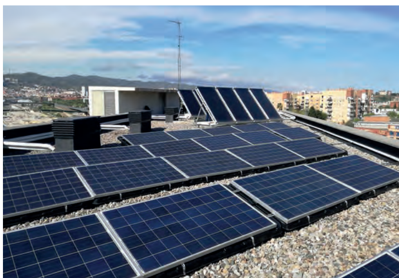
Col·lectors solars d'instal·lació solar tèrmica i fotovoltaica en edifici Barcelona
