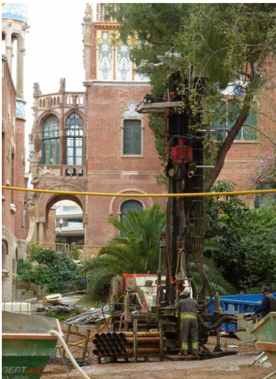
LES INSTAL·LACIONS DE GEOTÈRMIA COM LES QUE S'ESTAN APLICANT AL RECINTE MODERNISTA DE SANT PAU, AMB EL RECOLZAMENT DE L'IDAE, ÉS UNA DE LES ENERGIES RENOVABLES QUE ES VOLEN POTENCIAR A PARTIR D'ARA
