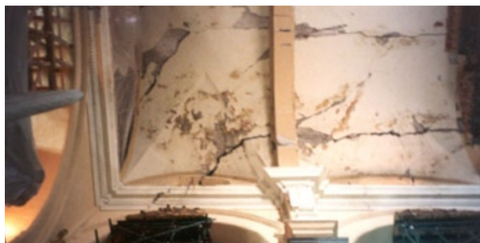
TEMPLO DE LA COMPAÑÍA, PUEBLA, MEXICO. DANYS DESPRÉS DEL SISME DE 1999. LA NAU CENTRAL VA PRESENTAR ESQUERDES DE FINS 6CM. AQUESTA ESGLESIÀ, ALS ANYS CINQUANTA, VA SER INTERVINGUDA AMB FORMIGÓ (RECONSTRUCCIÓ DE CÚPULA I VOLTES). EN AQUEST EXEMPLE ES VA COMPROVAR QUE: “LA RESPOSTA SÍSMICA DELS EDIFICIS HISTÒRICS ES SIGNIFICATIVAMENT DIFERENT DELS EDIFICIS MODERNES; AIXÒ ES DEU A LAS DIFERENTS FORMES I SISTEMES ESTRUCTURALS, AIXÍ COM A LAS DIVERSES PROPIETATS DELS MATERIALS” (MELI, R.2001.)
