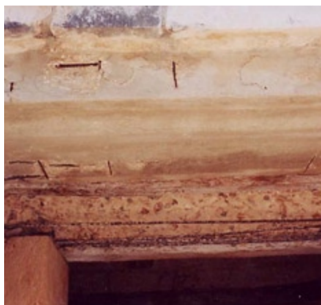
UXMAL, CUADRÁNGULO DE LAS MONJAS, MEXICO. (2005). DANYS A LA MAJORIA DE LES LLINDES REFORÇADES AMB FORMIGÓ ARMAT. PRESENCIA D'OXIDACIONS, SALS I CARBONATACIÓ DEL FORMIGÓ.
